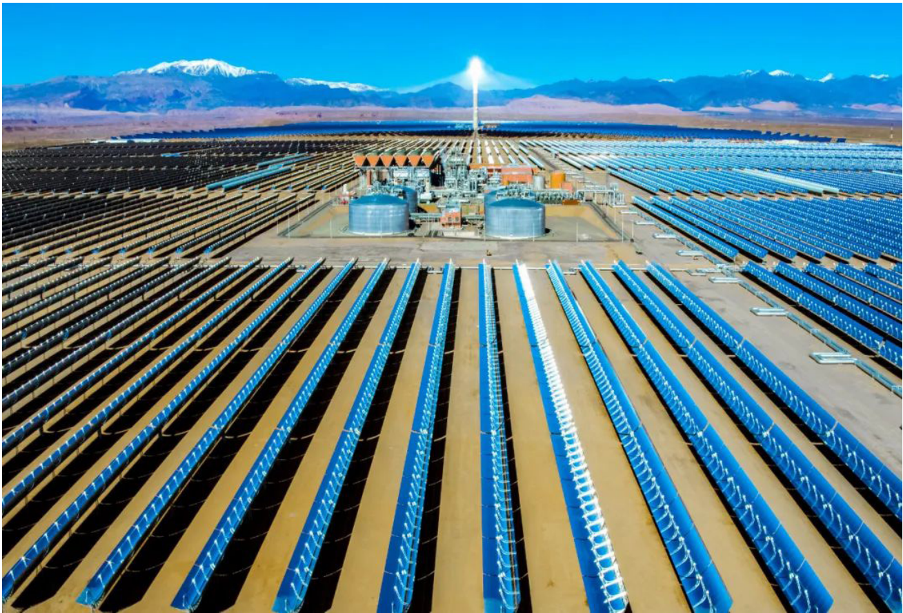
Figure 17 Centrale solaire thermique à tour Noor III au Maroc
